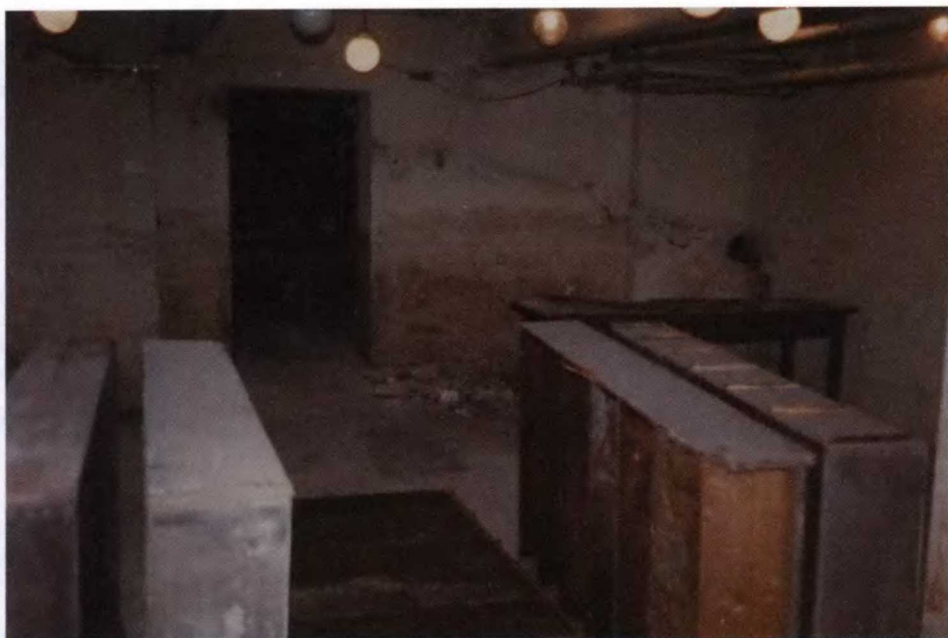
6. Regały drewniane w magazynach piwnicznych po powodzi w 1997 r.
