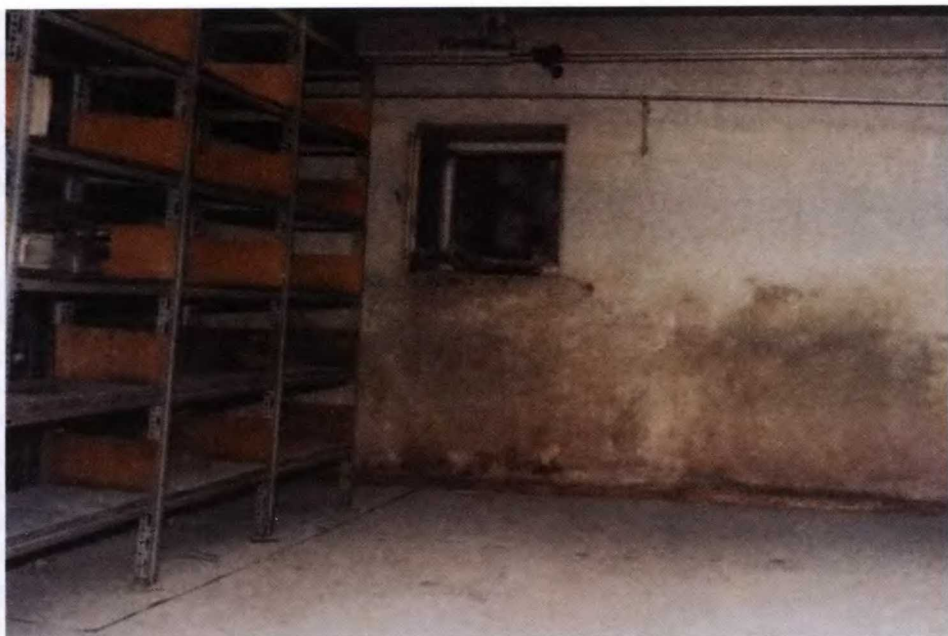
5. Piwniczne magazyny po lipcowej powodzi w 1997 r. z wyraźnie zaznaczoną linią poziomu wody popowodziowej
